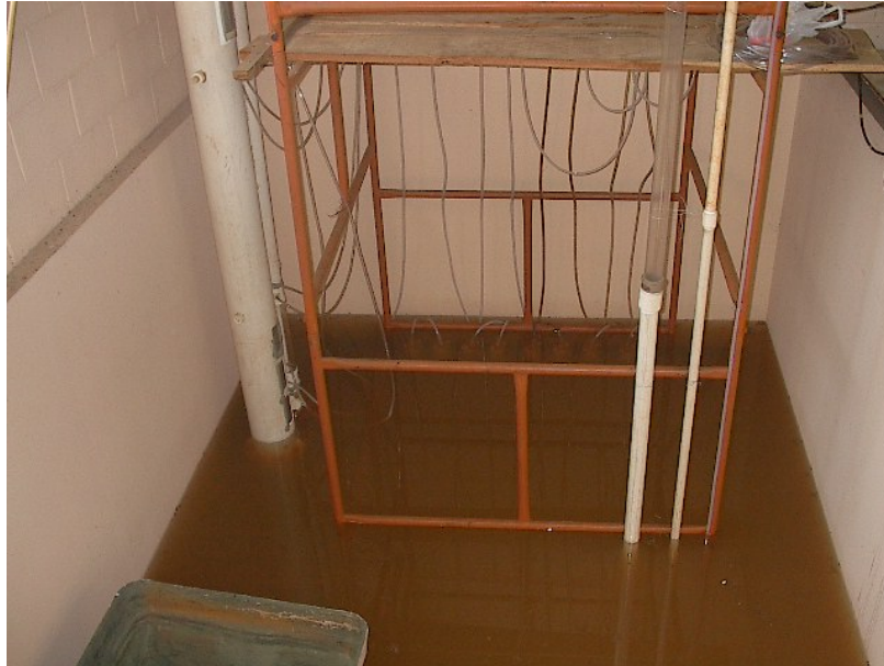
Figura 48: fosso do Laboratório de Hidrologia inundado.
