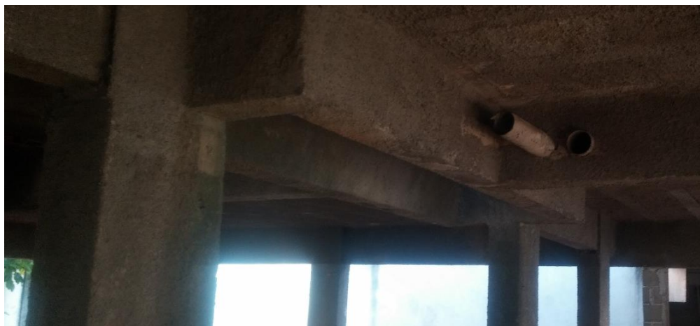
Fotografia 3 - Tubos de PVC atravessando viga - vista frontal
