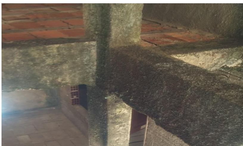
Fotografia 8 - Escurecimento de superfície de concreto devido a carbonatação
