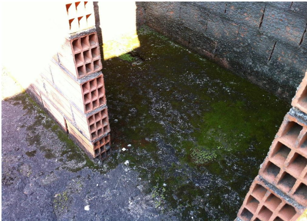
Fotografia 6 - Musgo no chão da estrutura
