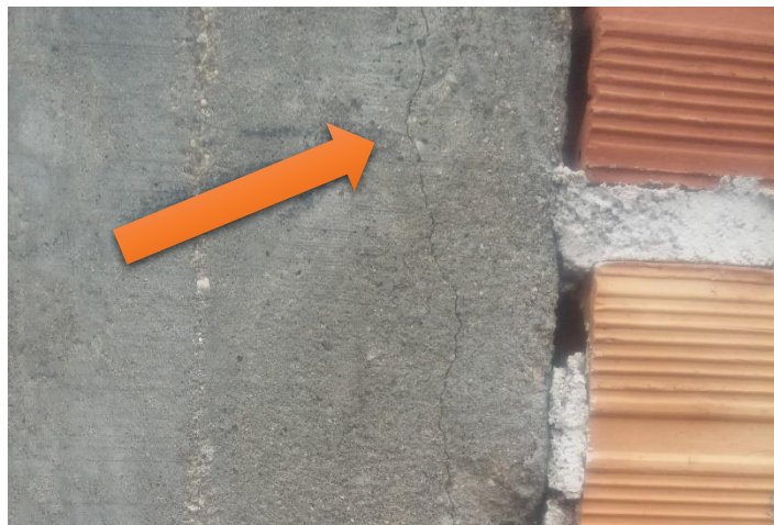
Fotografia 5 - Fissura gerada por expansão volumétrica
