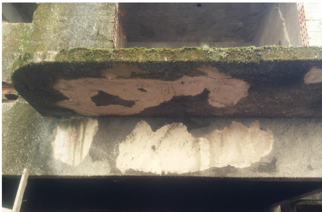
Fotografia 7 - Musgo na laje da varanda
