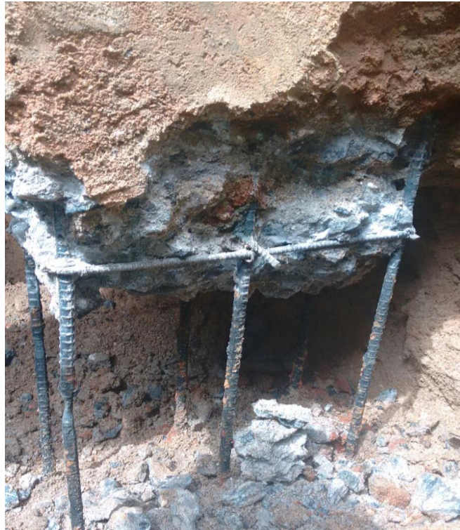
Fotografia 10 - Pilar sem apoio
