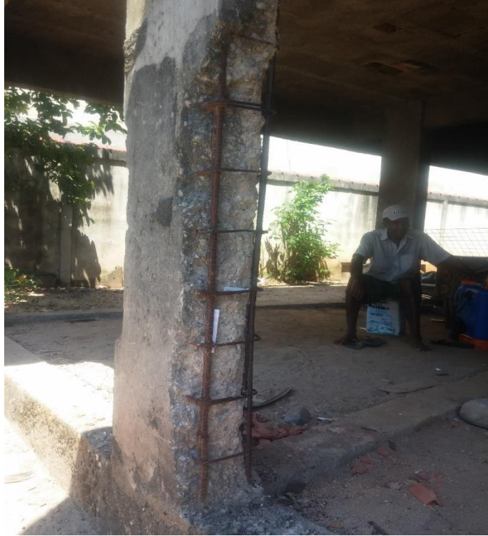
Fotografia 4 - Corrosão de armadura do pilar
