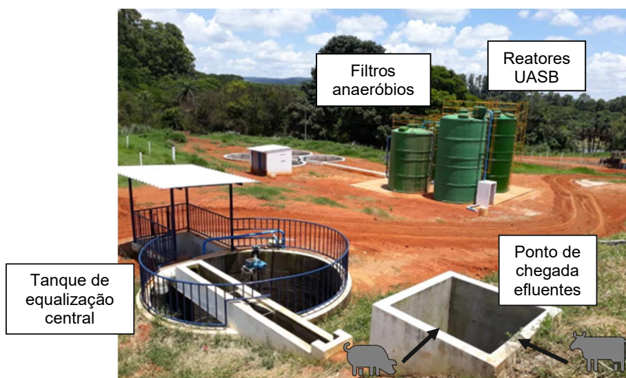
Figura 17 – Tanque de equalização central, reatores UASB e filtros anaeróbios
