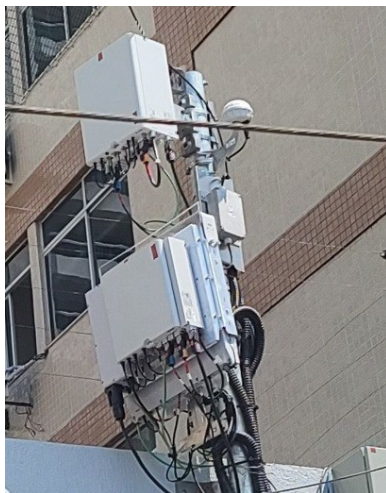
Figura 18 – Modelo small cell Nokia com antena 4G e 5G com baseband com aproximadamente 5 metros, focando em capacidade para suprir necessidade de conexões com os usuários em locais de alto tráfego, essenciais para densificação do 5G.
