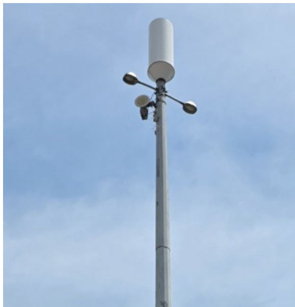
Figura 17 – Modelo poste metálico BIOSITE de 18 metros com radome que contém três antenas passivas setorizadas para 2G a 4G, o qual se camufla como poste de iluminação para se integrar harmonicamente ao ambiente urbano, os equipamentos, basebands e RRU's são instalados internamente.
