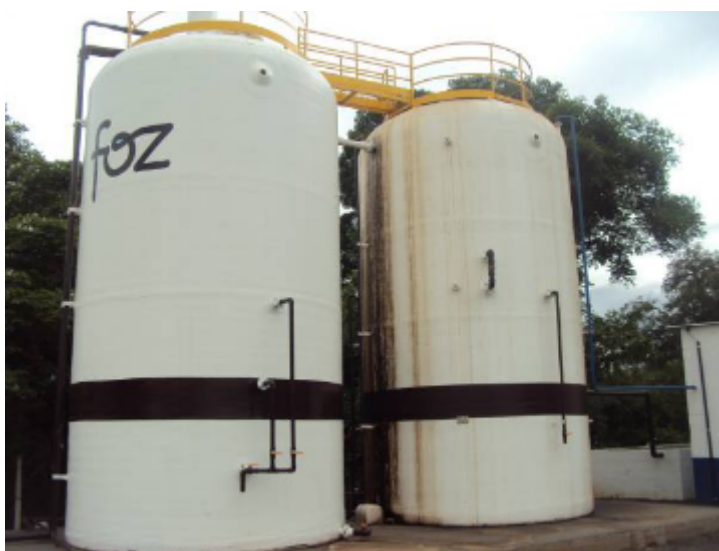
Figura 15 - Vista reator UASB e filtro aeróbio submerso ETE Batovi
