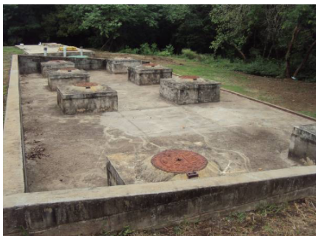
Figura 14 - Vista do tratamento ETE Assistência Baixa
