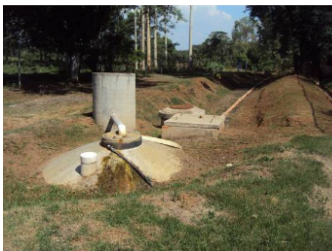
Figura 17 - Vista do tratamento vala de Infiltração e Reator UASB da ETE Ferraz, Rio Claro
