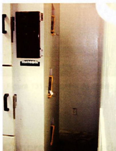
Figura 127 – Multímetros na Lateral do equipamento
