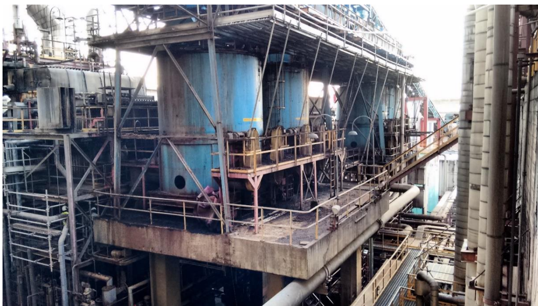
Figura 29: Silos de Biomassa das caldeiras de força
