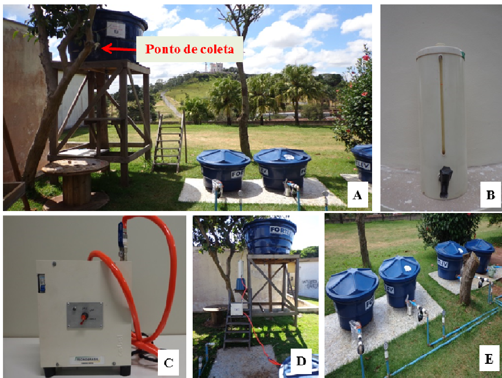
Figura 8. (A) Reservatório de água de reuso de 1000L e ponto de coleta das amostras; (B) Filtro com areia; (C) Aparelho de ozonização; (D) Montagem do processo de tratamento da água de reuso e (E) Reservatório da água de reuso ozonizada
