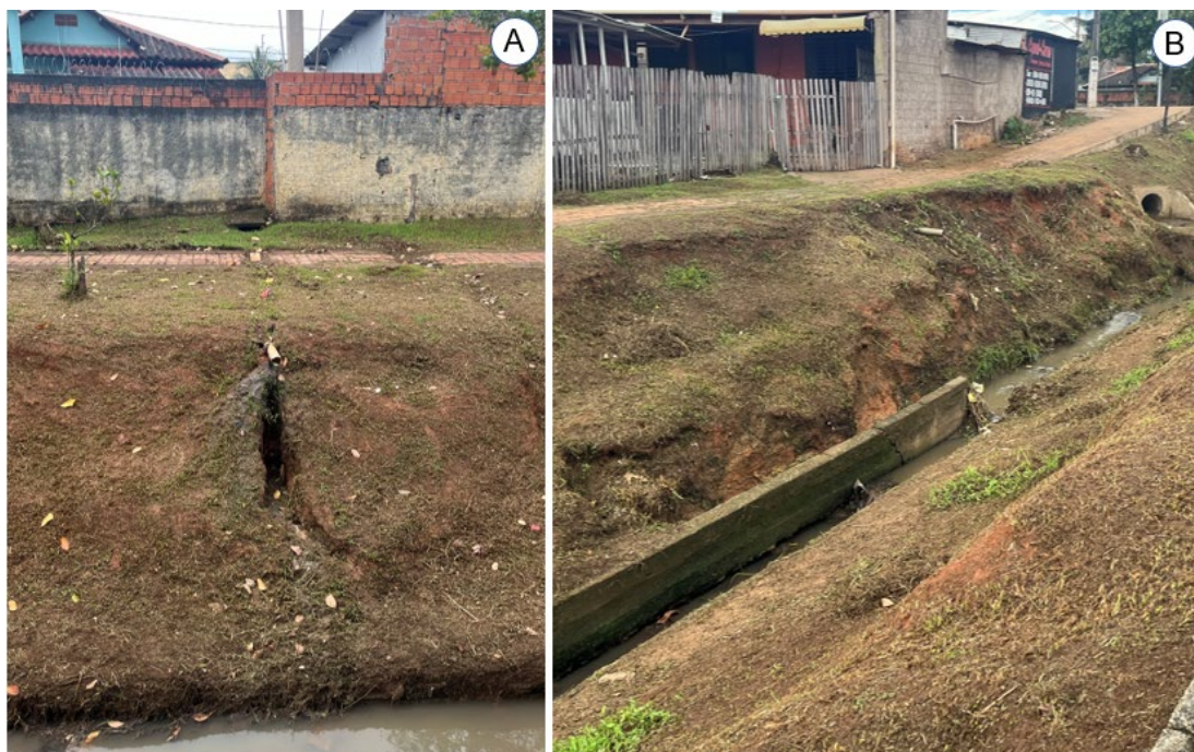
Figura 9 – Erosão em sulco causada por ligação clandestina de esgoto no polígono 17 (A) e erosão laminar no polígono 18 (B)
