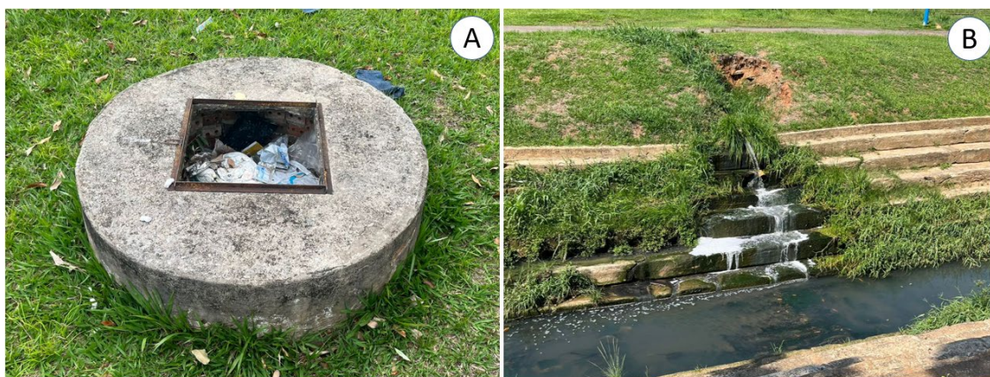
Figura 19 – Poço de visita sem vedação no polígono 20 (A) e evidência de lançamento de esgoto no igarapé no polígono 32 (B)
