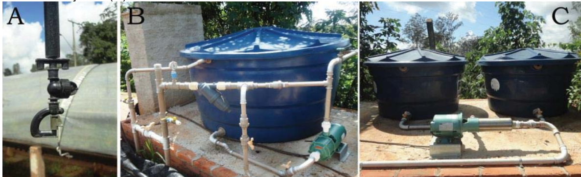
Figura 2 - Microaspersor invertido com válvula antigotas (A); painel de controle (ao fundo), caixa d'água de 1500 litros, filtro de disco, manômetro e motobomba centrífuga (B); caixas d'água de 500 litros e motobomba injetora (C)
