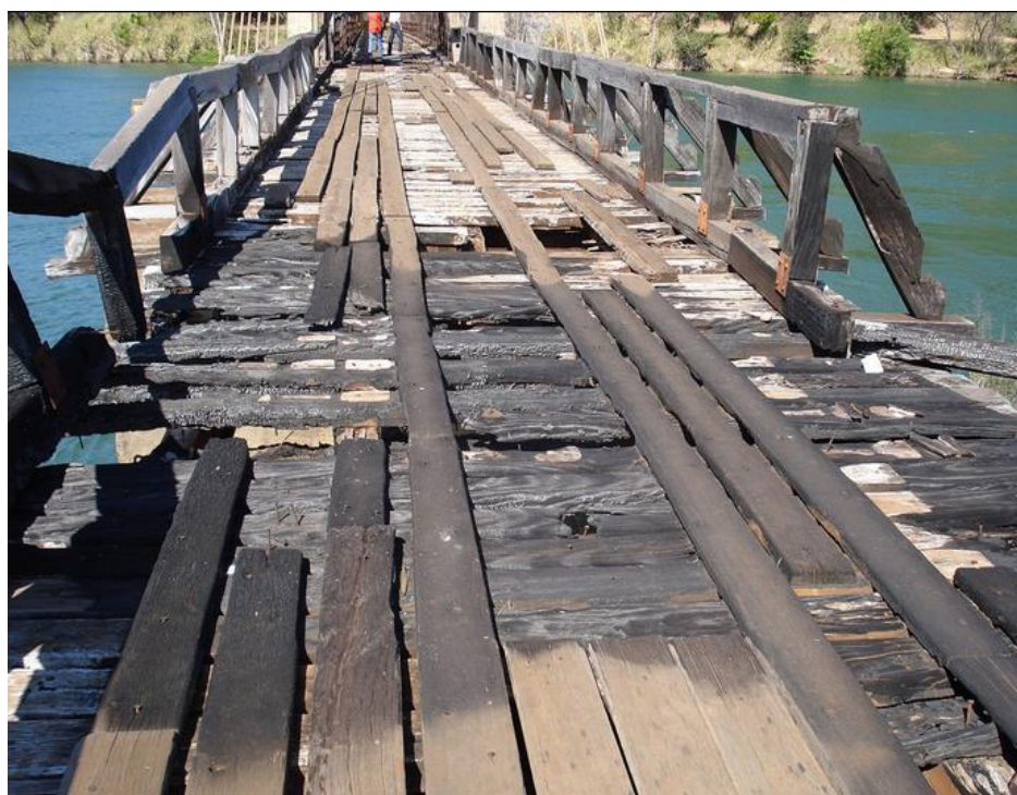
Figura 7: Cenário da ponte pênsil antes de sua reconstrução
