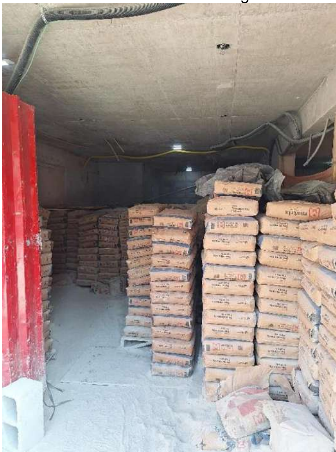
Figura 28 – Mau armazenamento da argamassa ensacada
