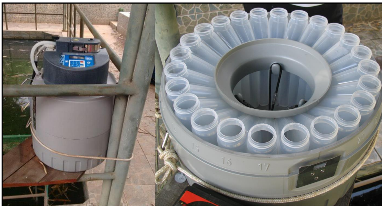
Figura 12. Foto do amostrador automático ISCO 6400 instalado para o monitoramento da nascente.
