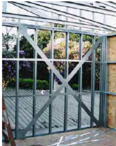
Foto 3.1 - Painel com contraventamento em “X”
