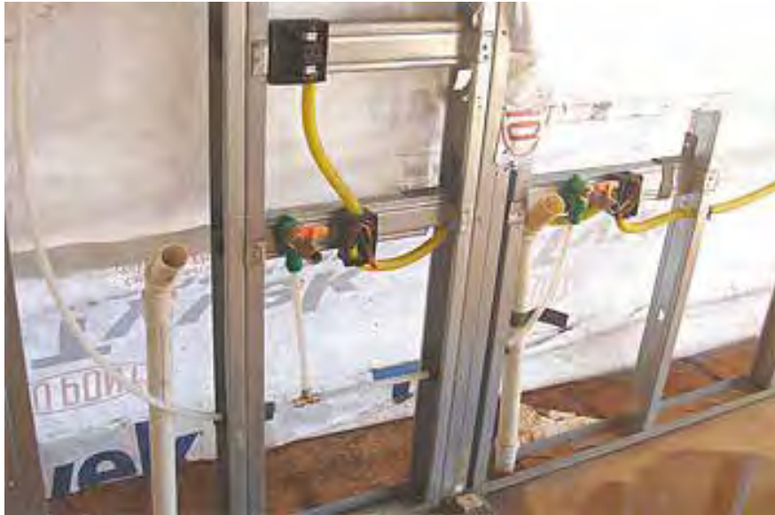
Foto 2.26 - Facilidade de visualização de interferências entre instalações elétricas e hidráulicas
