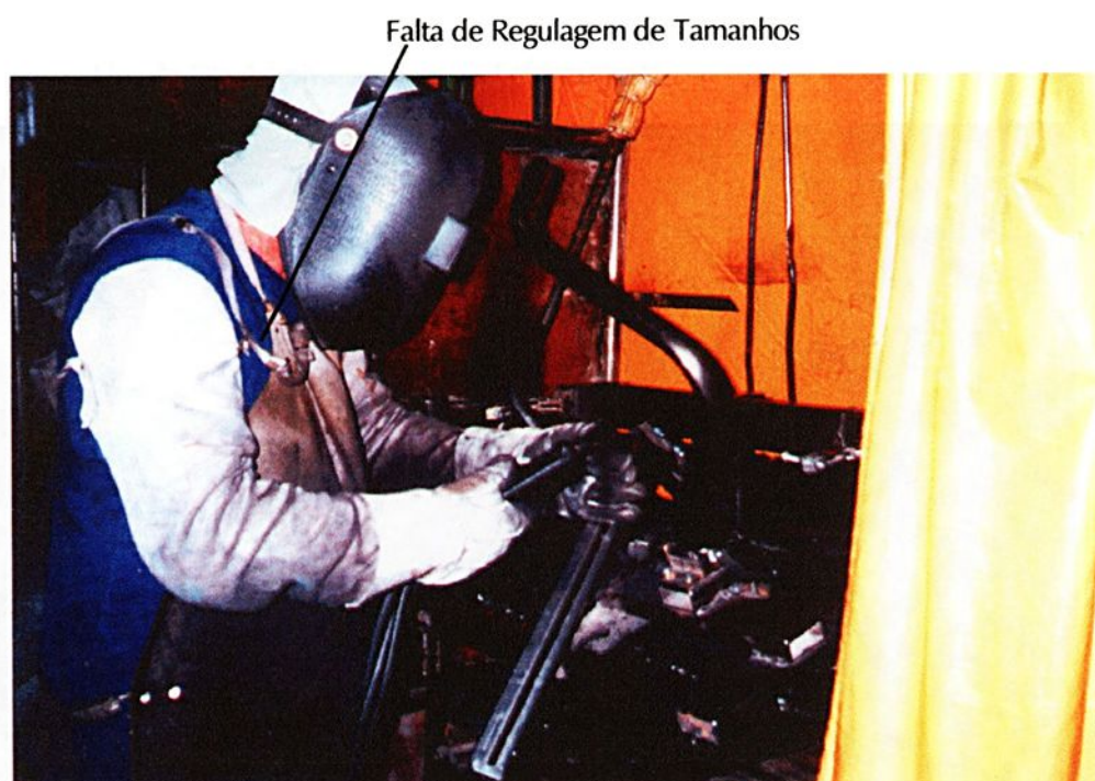
Figura 82 - Falta de Regulagem dos Atuais Mangotes Foto: J. E. Zago
