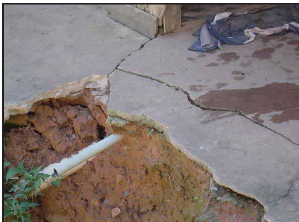
Figura 14 – Presença de trincas no piso. Fonte: Ministério das Cidades (2006)
