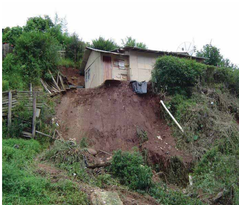
Figura 10 – Escorregamento planar de solo em aterro lançado Fonte: Ministério das Cidades (2006)
