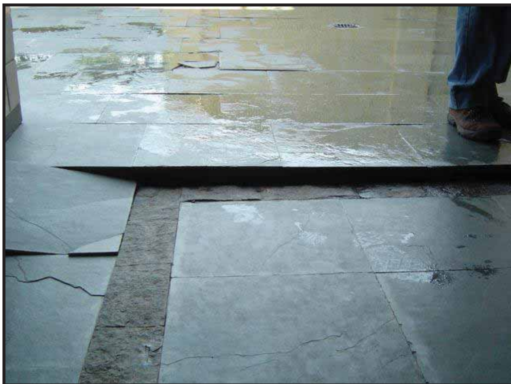
Figura 13 – Degrau de abatimento observado no piso de moradia Fonte: Ministério das Cidades (2006)
