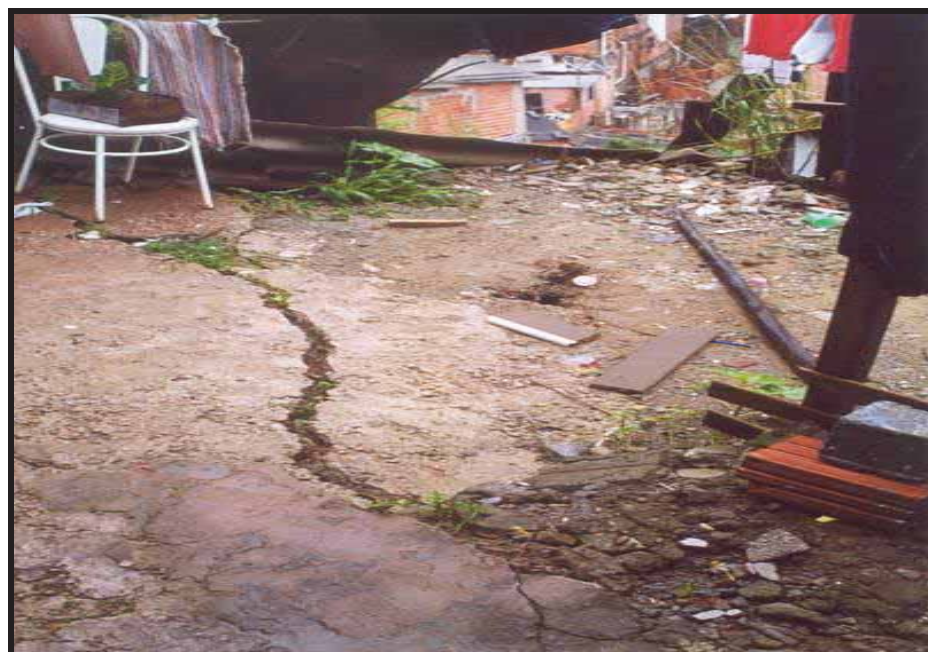
Figura12– Presença de trincas no solo ou em aterro indicativo de feição de instabilidade Fonte: Ministério das Cidades (2006)
