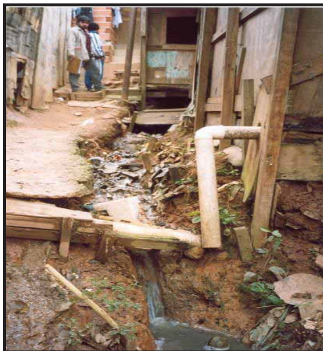
Figura 17 – Evidencia de instabilidade causada pelo lançamento de água de esgoto na superfície do terreno
