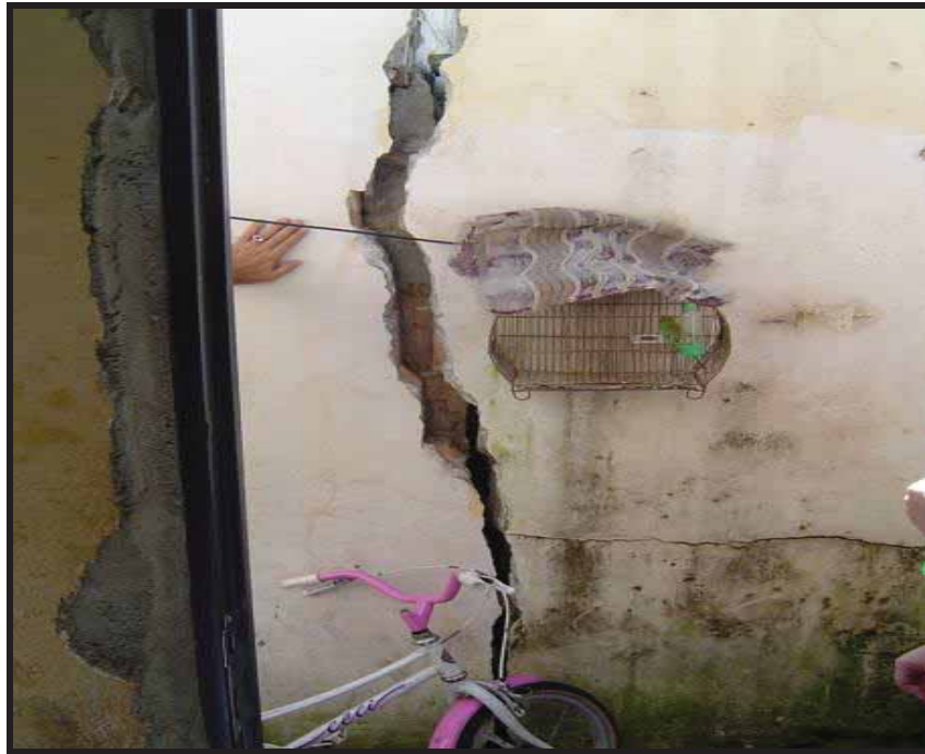
Figura 15 - Trincas em paredes de moradia indicando instabilidade do terreno. Fonte: Ministério das Cidades (2006)
