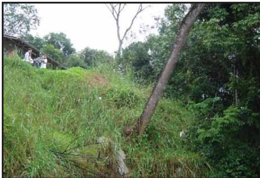
Figura 11 – Árvore com inclinação, evidenciando a instabilidade do terreno. Fonte: Ministério das Cidades (2006)
