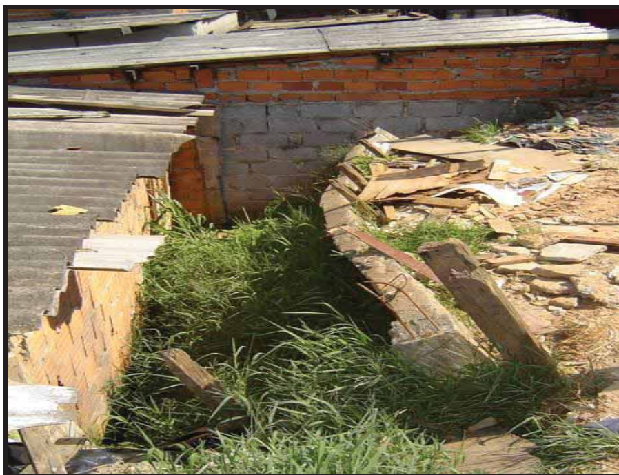
Figura 16 - Muro encurvado indicando a possibilidade de ocorrência imediata de ruptura. Fonte: Ministério das Cidades (2006)
