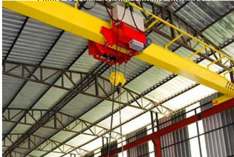
Figura 3 - Ponte Rolante Univiga Suspensa
