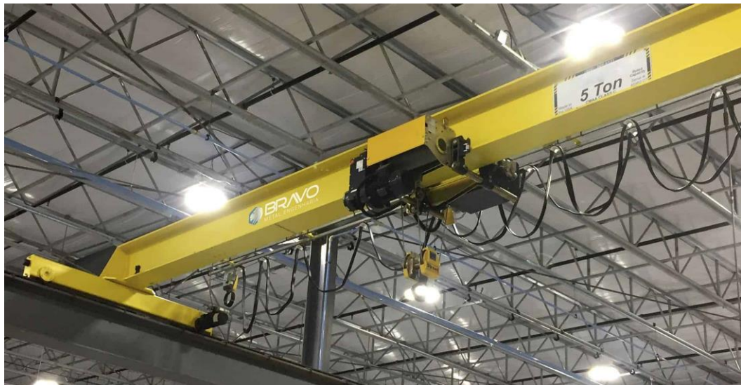
Figura 4 - Ponte Rolante Univiga
