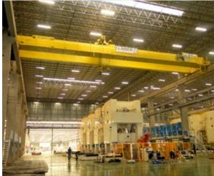
Figura 5 - Ponte Rolante Dupla Viga
