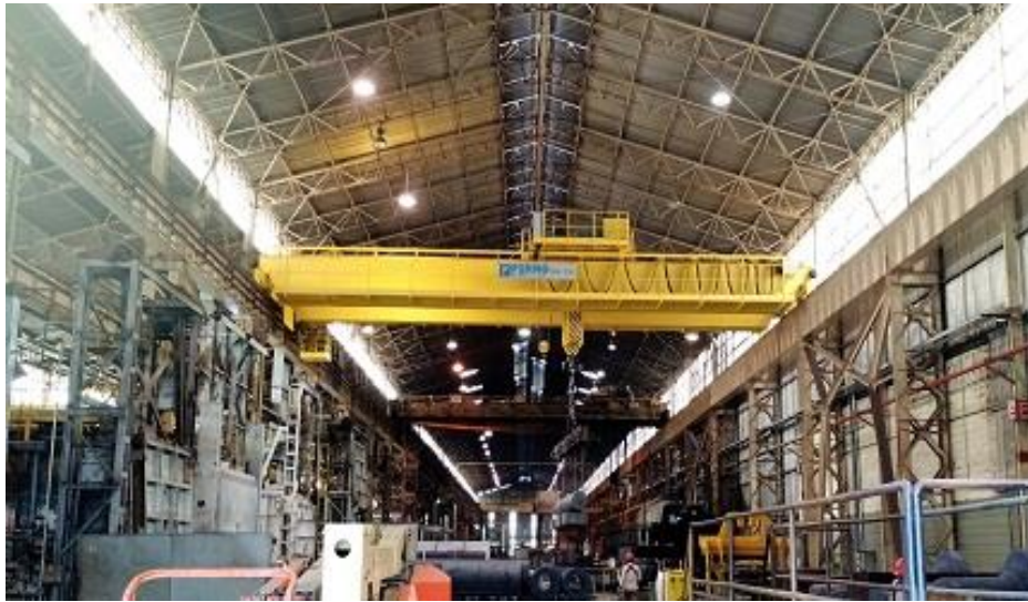
Figura 8 - Ponte Rolante com Aplicação em Indústria Siderúrgica
