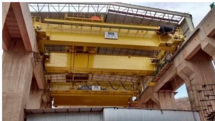
Figura 1 – Ponte rolante utilizada na Usina Hidrelétrica Sinop
