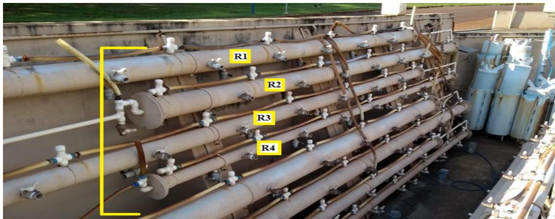
FIGURA 3. Sistema de tratamento composto por reatores anaeróbios horizontais de leito fixo e alta taxa (RHALF) – R1, R2, R3 e R4.
