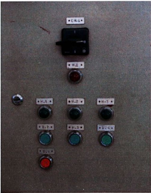
Figura 24 - Painel de controle da bomba hidráulica elétrica
