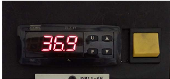
Figura 61 - Termostato Digital indicando a temperatura do Fluido Lubrificante.
