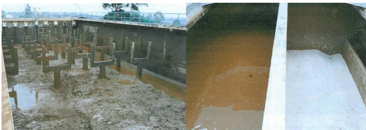
Figura 10: O decantador no momento da lavagem e o filtro, na ETA II de Rio Claro-SP, respectivamente.
