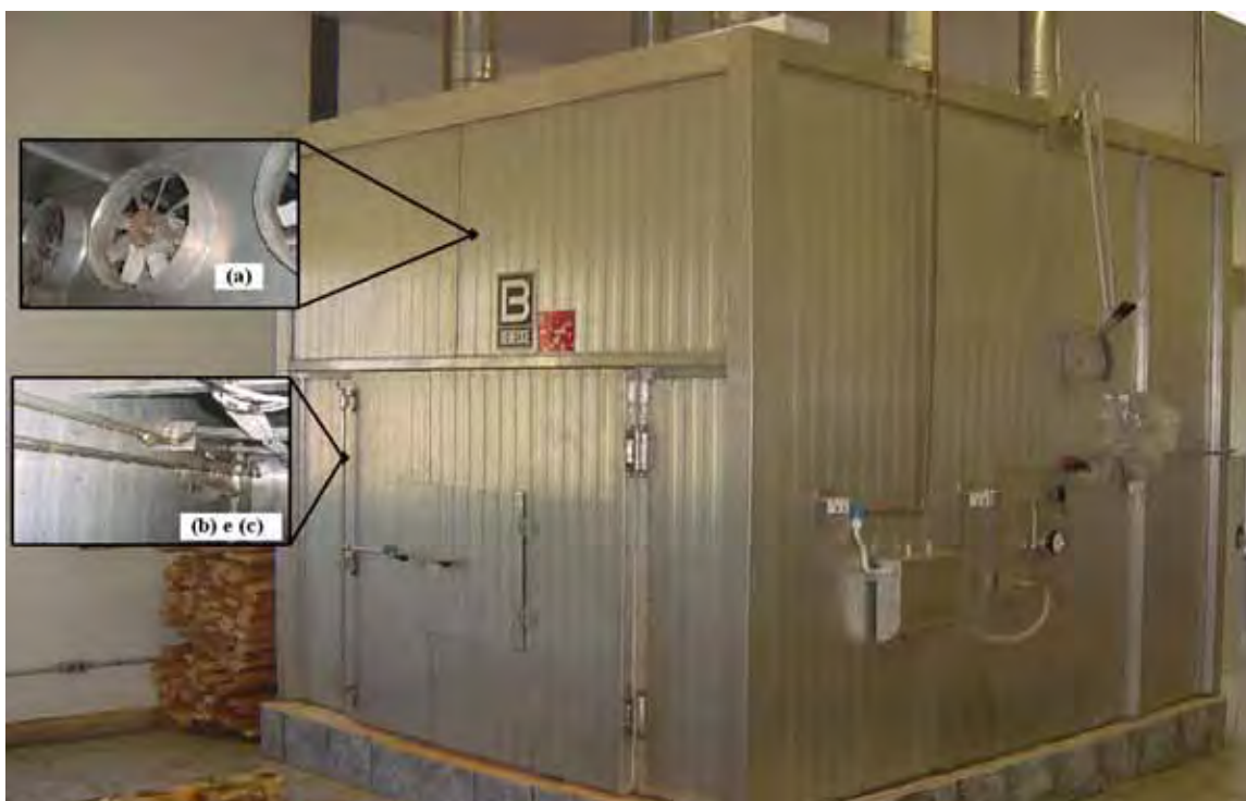
Figura 17. Vista geral da estufa de secagem de madeira e sistemas de: (a) ventilação, (b) umidificação e (c) aquecimento.
