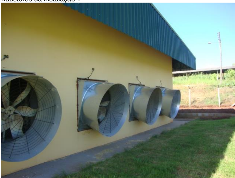
Figura 10 - Exaustores da instalação 1
