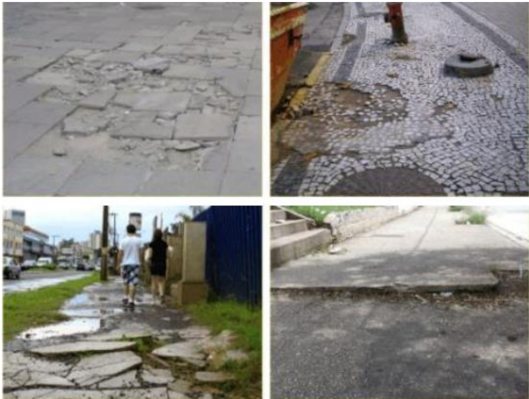
Figura 3 – Exemplos de calçadas com mal estado de conservação
