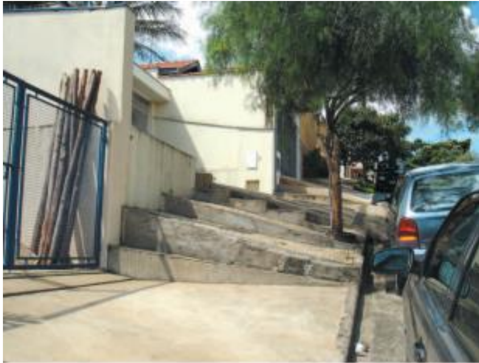
Figura 8 – Exemplos de degraus em calçadas
