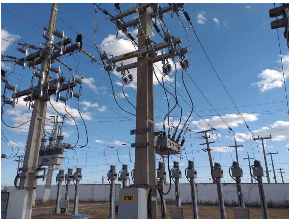
Figura 8 – Linhas de Distribuição de Energia Elétrica
