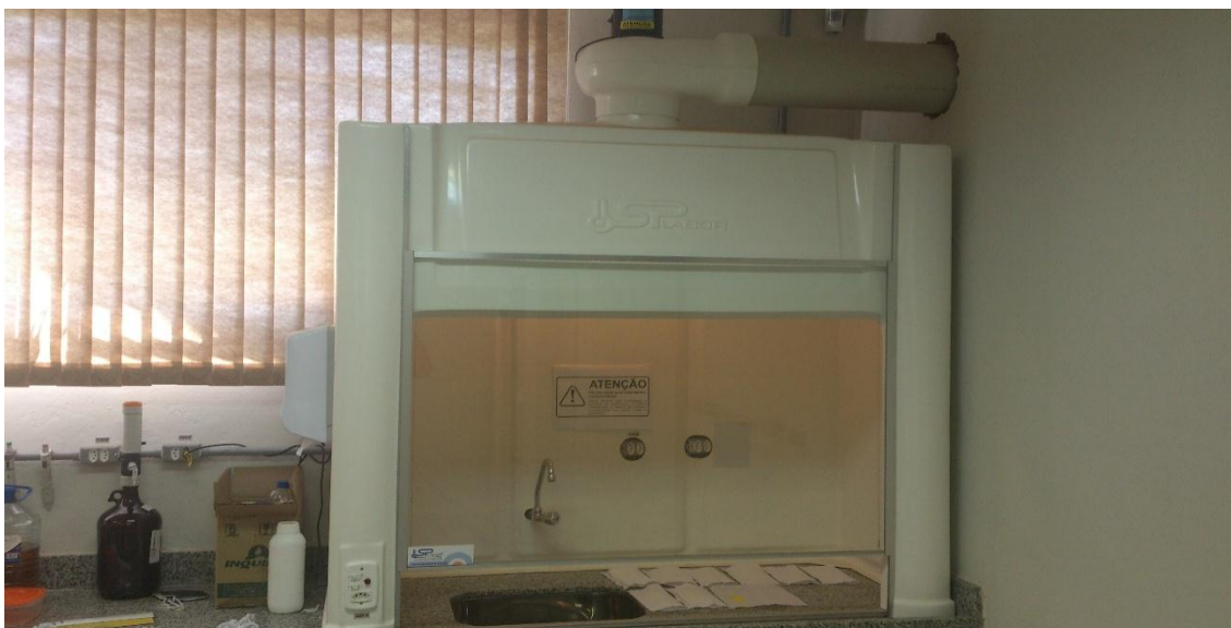
Figura 3. Capela para exaustão de gases, marca SPLabor ® , utilizada para fazer a secagem dos papéis.
