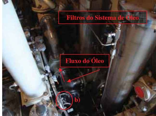
Figura 30: Localização dos filtros de óleo próximo ao ponto de coleta b).
