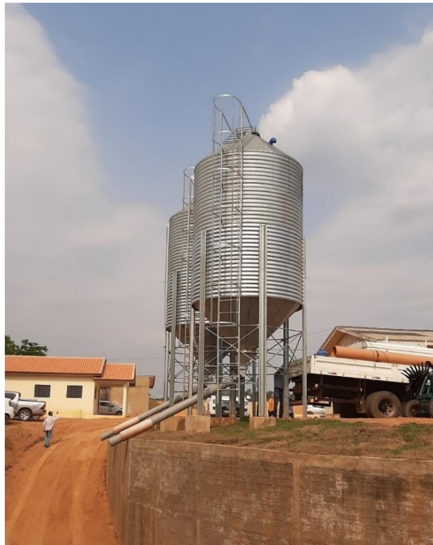
Figura 29 – Silo para armazenamento de rações à granel para alimentação de peixes.
