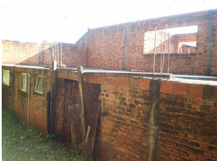
Figura26: Distrito de Gardênia, meio rural, construção embargada pelo Instituto Brasileiro do Meio Ambiente e dos Recursos Naturais Renováveis (IBAMA).
