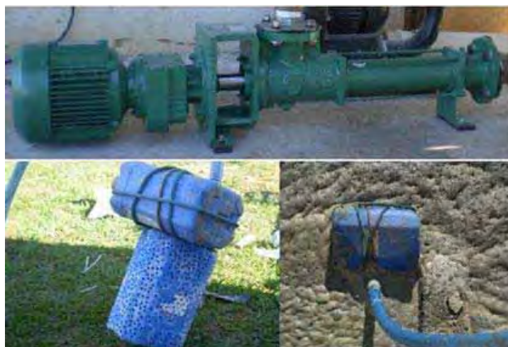
Figura 16 – Vista da bomba de sucção e a extremidade do tubo de sucção
