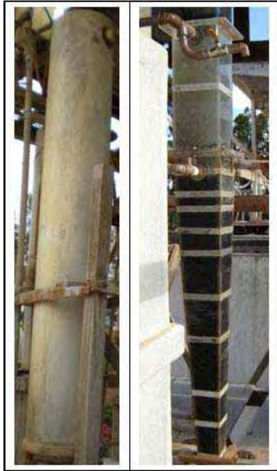
Figura 11 – Decantador de coluna e floculador de manta de lodo
