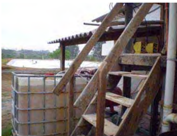
Figura 19 – Reservatório de coagulante e bombas dosadoras
