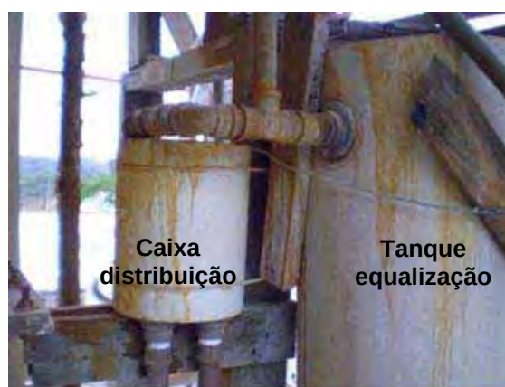
Figura 18 – Tanque de equalização e caixa de distribuição
