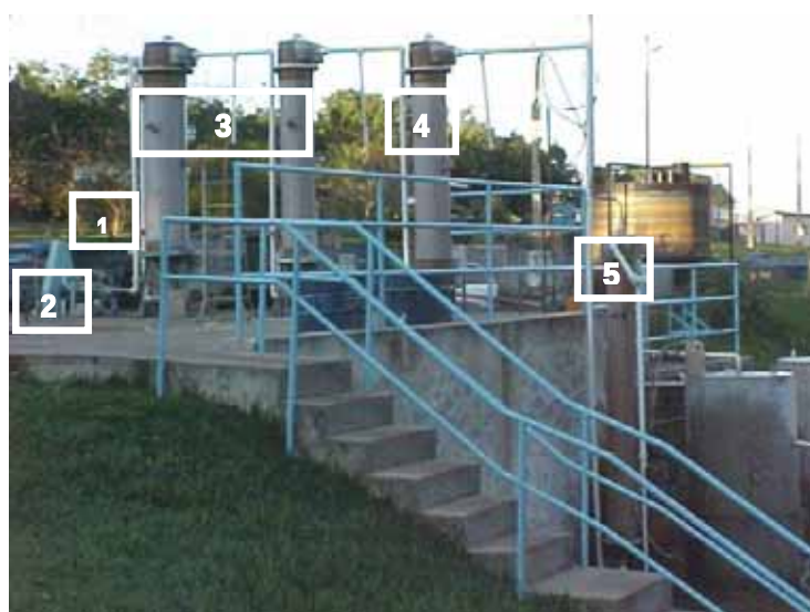
FIGURA 4. Instalações experimentais composta pelo reator anaeróbico compartimentado (ABR), filtro aerado submerso (FAS) e reator de fluxo ascendente com manta de lodo (USB) anóxico, em série. (1) depósito do afluente; (2) bomba helicoidal; (3) reator anaeróbico compartimentado-ABR; (4) filtro aerado submerso-FAS; (5) reator de fluxo ascendente com manta de lodo-USB anóxico. Fonte: Adaptado de FERNANDES (2004).
