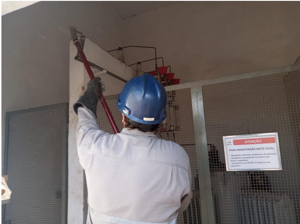
Figura 55: Desligamento da energia que chega ao transformador.
