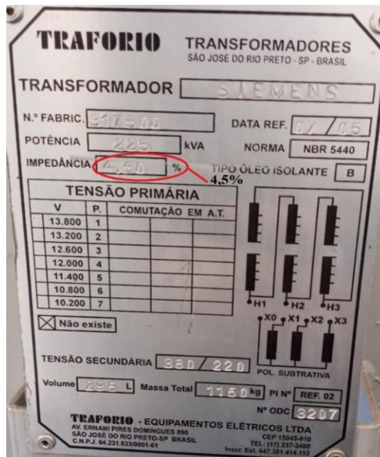
Figura 47: Placa com as informações do transformador.
