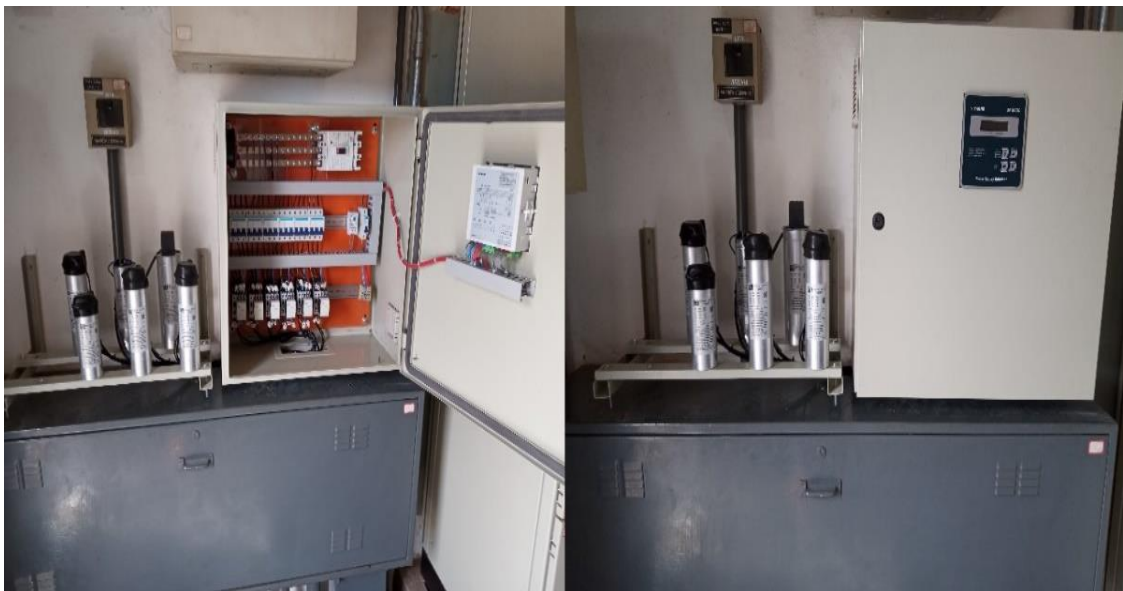
Figura 54: Estrutura do banco de capacitores instalada.
