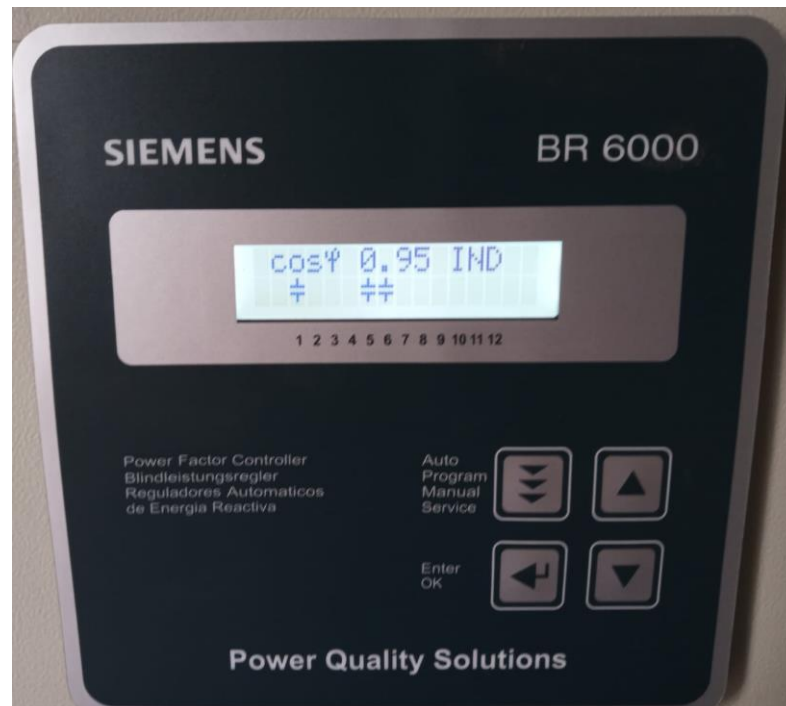
Figura 62: Verificação da correção do fator de potência pelo controlador.
