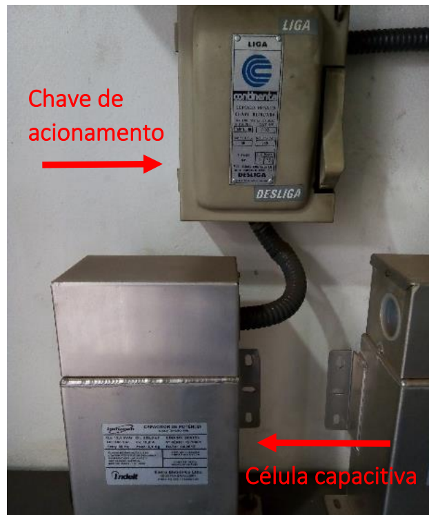
Figura 11: Conjunto chave de ligação e banco de capacitores.
