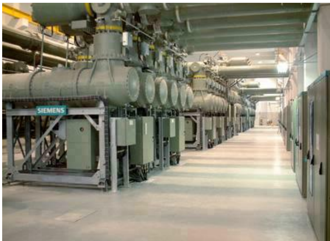
Figura 8 - Subestação isolada a gás.
