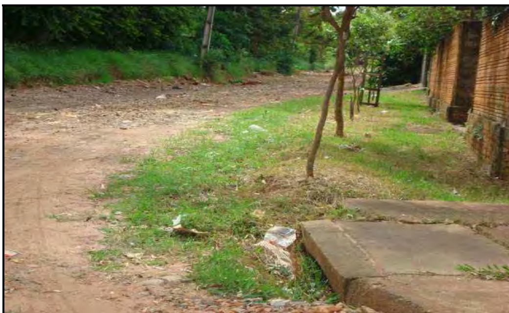
Figura 7.1 – Rua sem pavimentação asfáltica (Bairro San Fernando Vally – Assis/SP) Foto: E. C. Oliveira, mar./2009
