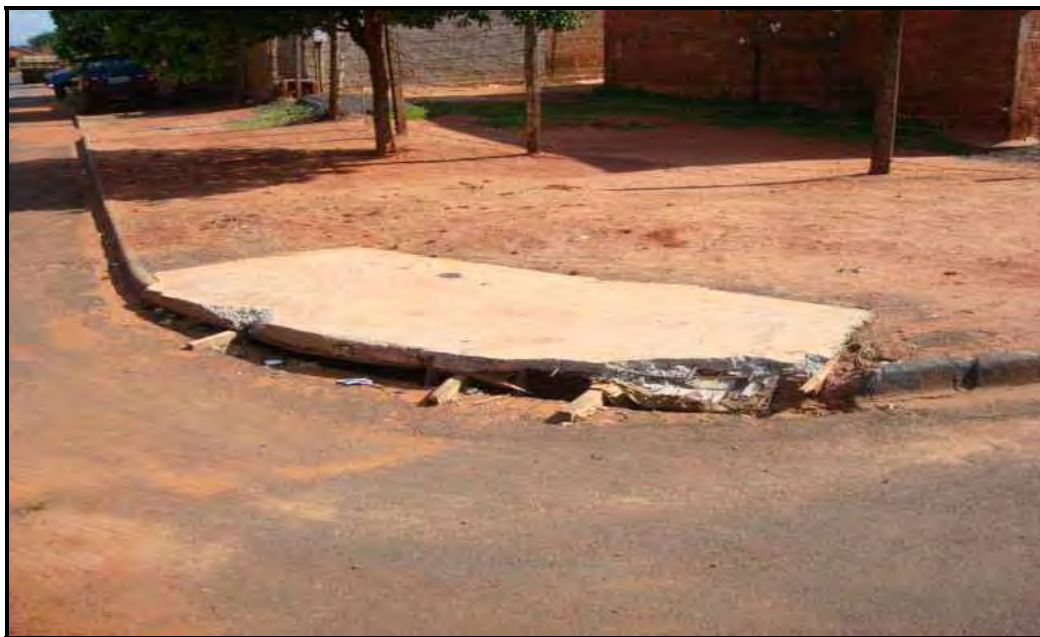
Figura 7.4 – Galeria de água pluvial (Jd. Das Oliveiras – Paraguaçu Paulista/SP) Foto: E. C. Oliveira, abr./2009
