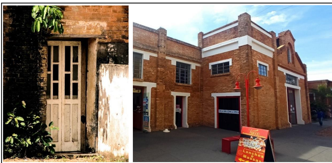
Figura 68 - Esquadria de madeira antes da intervenção e esquadrias após a intervenção.
