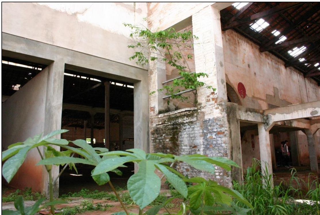
Figura 57 - Detalhe da vegetação invasora na área interna do Bloco 1 em 2006.
