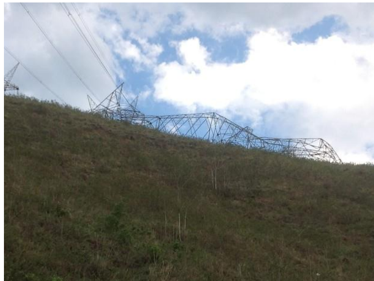
Figura 17 - Torres de transmissão caídas após chuva forte no Sul do estado do Rio de Janeiro
