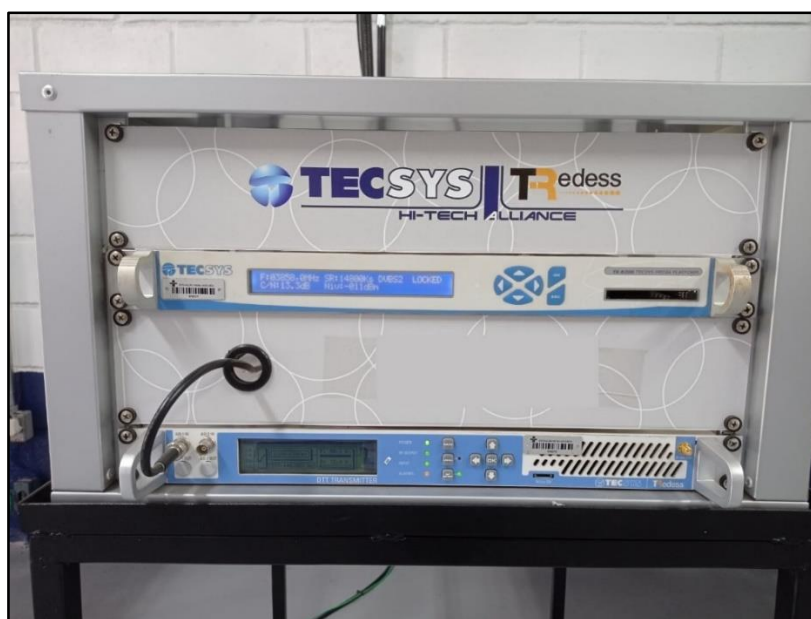
Figura 47 - Receptor e transmissor da estação retransmissora.
