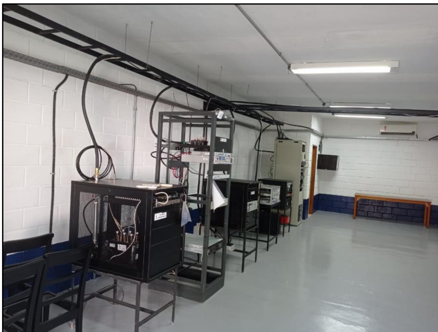
Figura 46 - Interior do abrigo da retransmissora.
