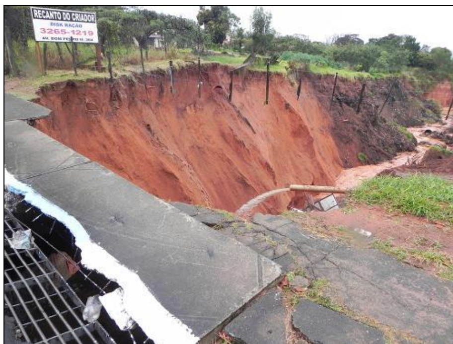
Figura 97 – Boçoroca atinge calçada da Avenida Dom Pedro II
