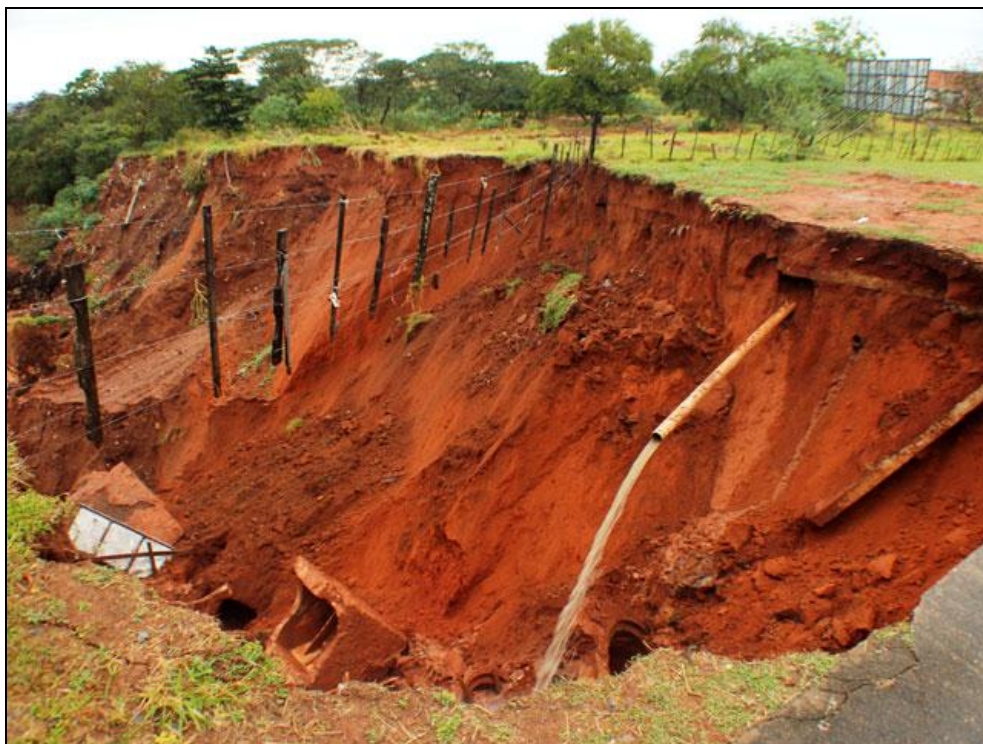
Figura 98 – Destruição de estruturas de distribuição de água e coleta de esgoto
