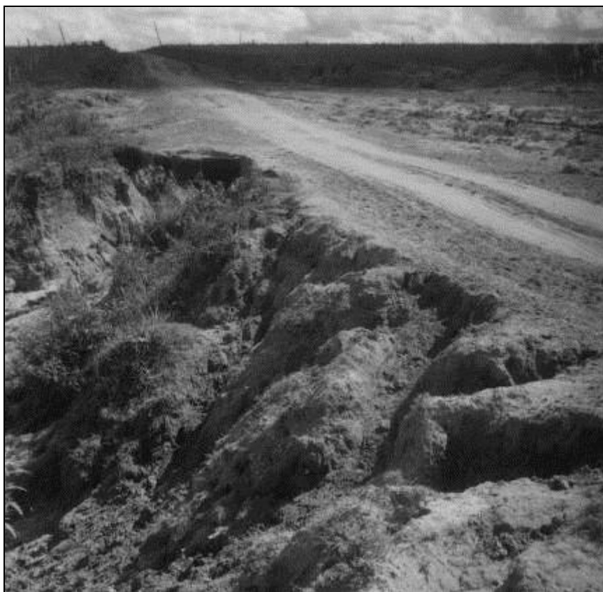
Figura 29 – Estrada ameaçada por processos erosivos, município de Rancharia.
