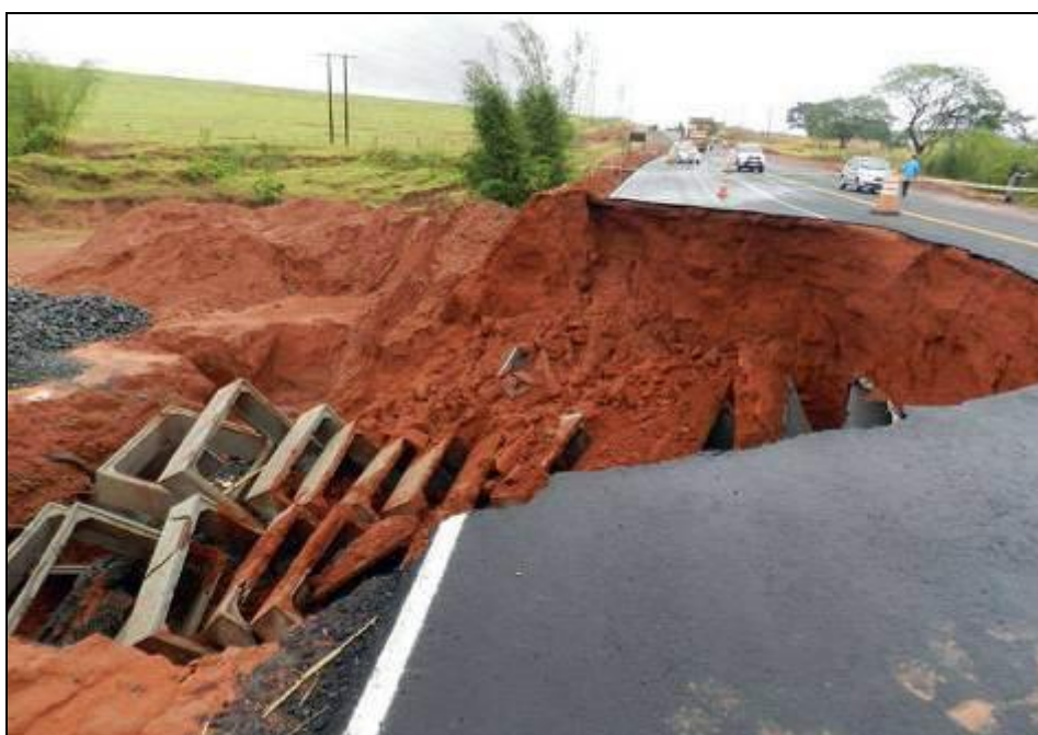
Figura 42 – Danos causados à infraestrutura rodoviária.
