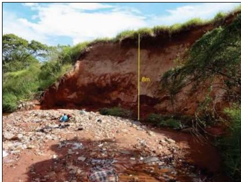
Figura 84 – Talude na margem direita da boçoroca.
