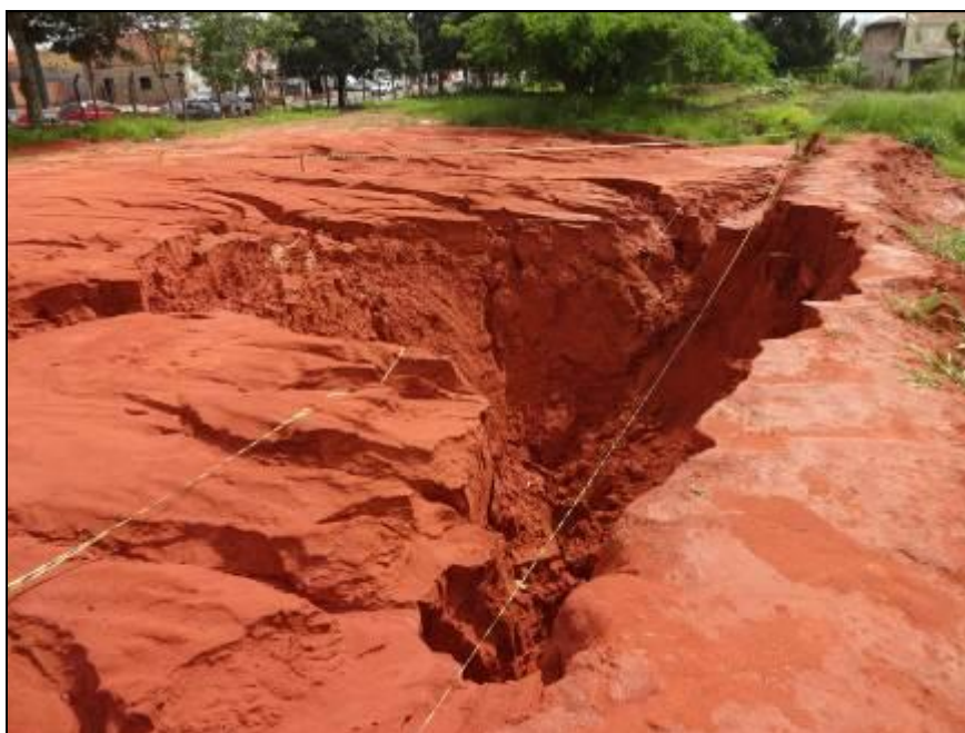
Figura 78 – Ravina formada no aterro após a implantação das obras de controle da erosão urbana.
