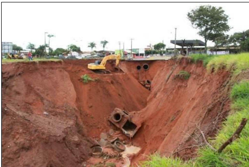
Figura 69 – Boçoroca do Córrego do Grito após erosão remontante.
