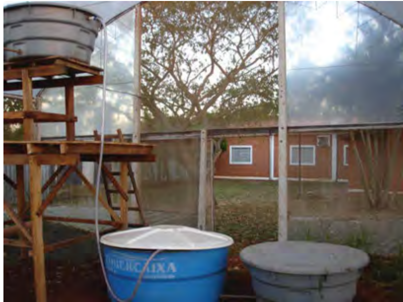
Figura 18. Detalhe da alimentação/armazenamento do efluente nos CWSs.
