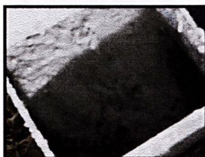
FIGURA 3.7 - Caixa de Entrada Entupida
