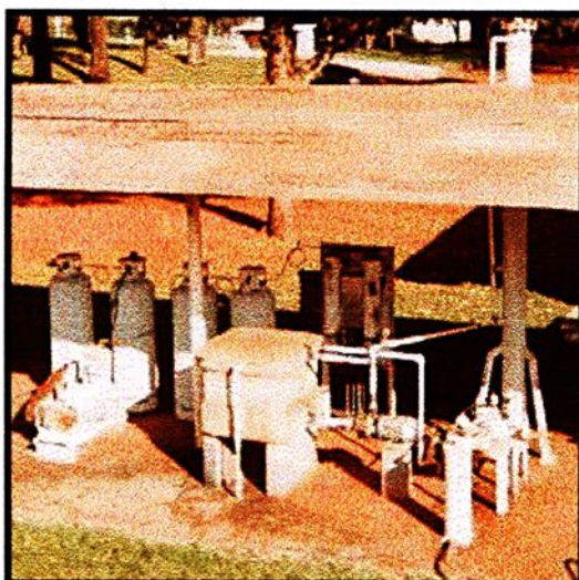
FIGURA 2.9 – Instalação de Purificação e Compressão de Biogás
