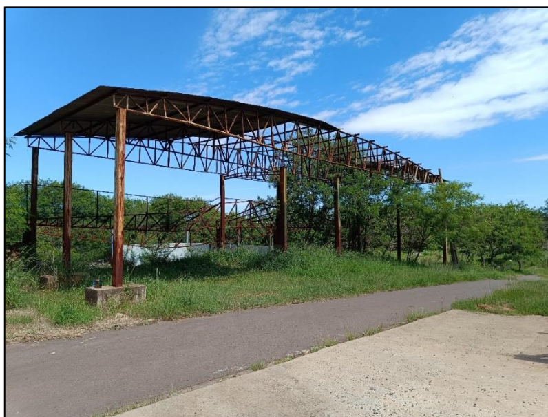
Figura 14 - Estrutura remanescente do antigo barracão da Cooperlix, após o incêndio de 2018
