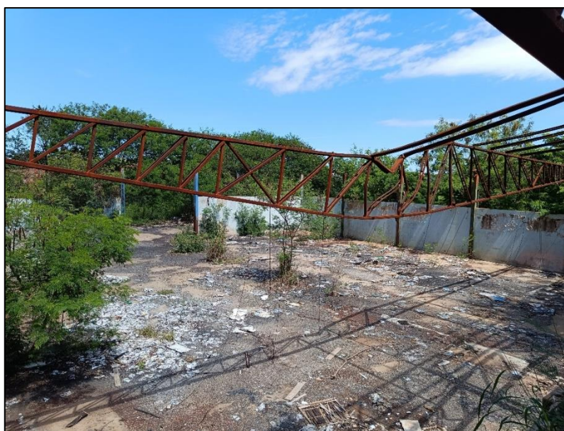
Figura 15 - Área interna do antigo barracão da Cooperlix, após incêndio de 2018
