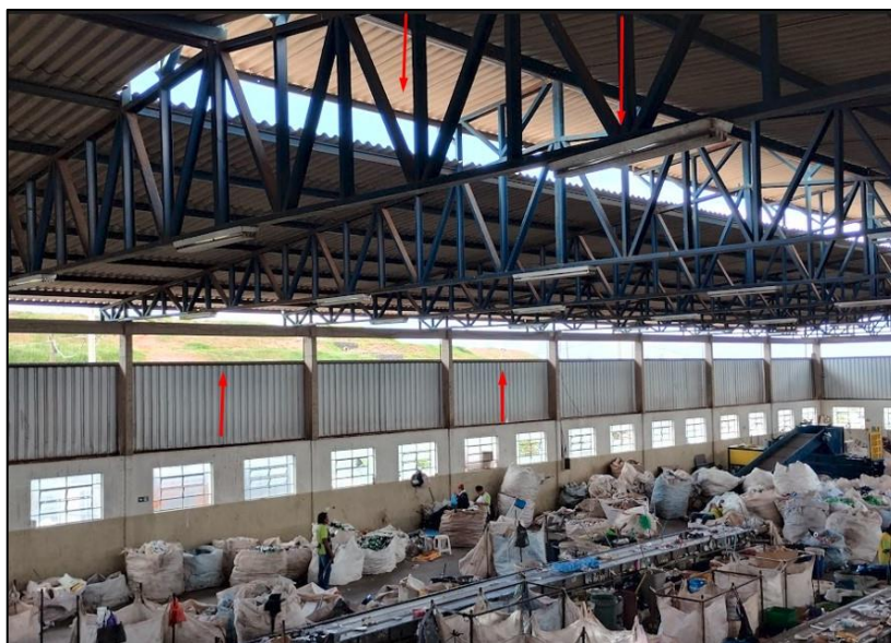
Figura 28 - Vãos na cobertura do barracão que comprometem as condições de trabalho em dias de chuva e ventania
