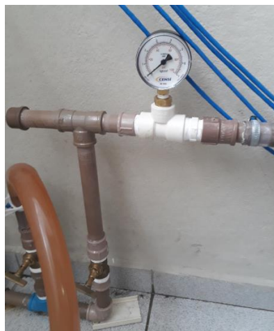
Figura 17 – Manômetro instalado no registro de água da máquina de envase
