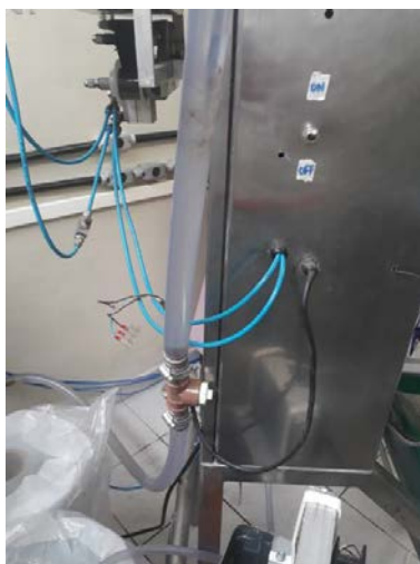
Figura 15 – Mudança na tubulação de passagem de água para resfriamento
