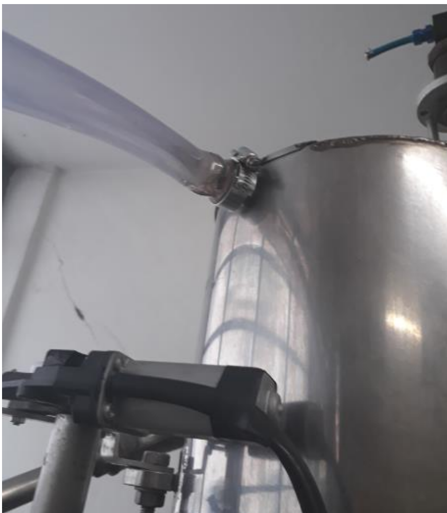
Figura 14 – Mangueira de escape do excesso de água no nível superior da máquina
