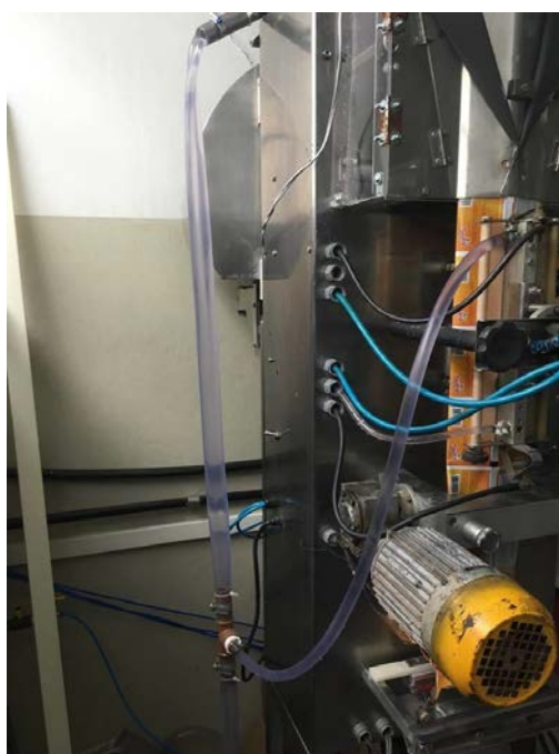
Figura 13 – Controle de nível do reservatório e resfriamento do sistema
