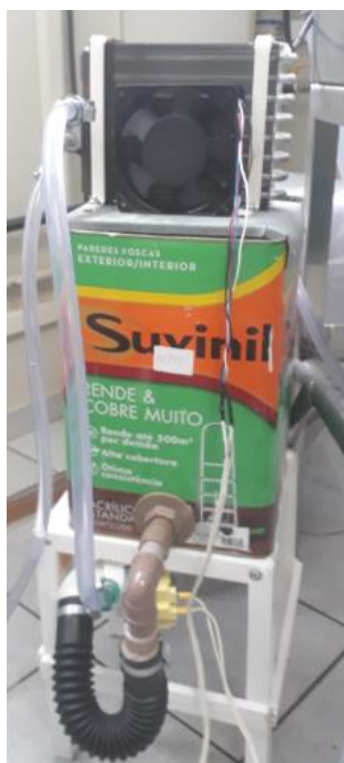
Figura 16 – Refrigerador para resfriamento do sistema
