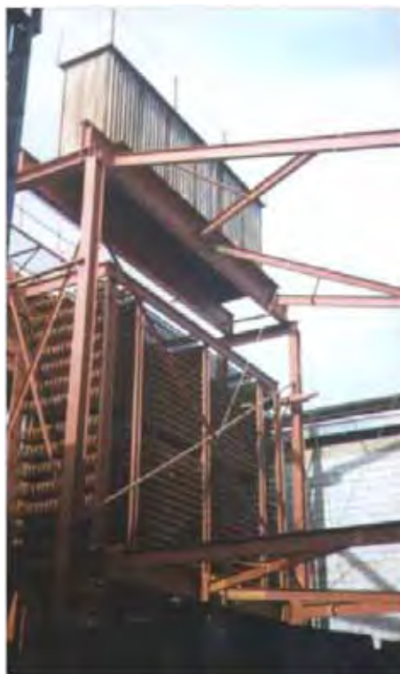
Figura 6 - Foto de um pré-aquecedor de ar (parte de cima) e um economizador (parte de baixo).
