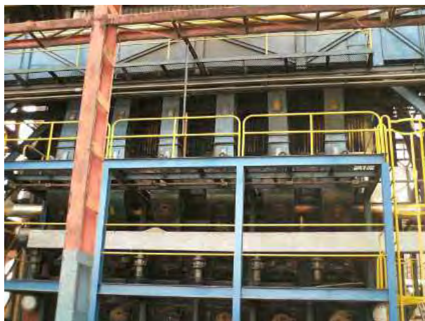
Figura 3 - Foto de um conjunto de dosadores de bagaço.
