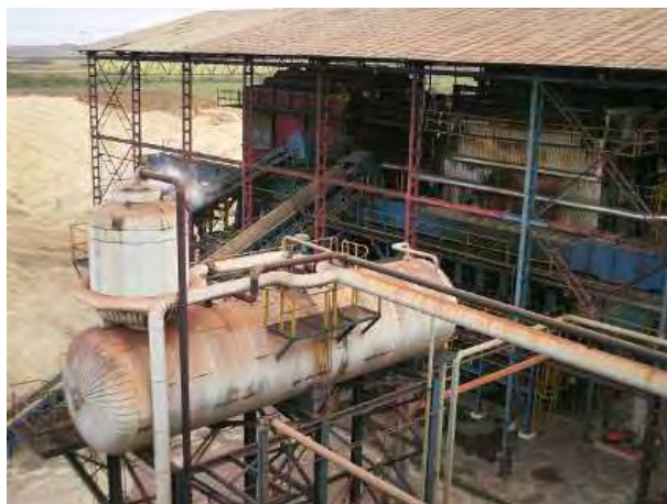
Figura 9 - Foto de um desaerador.
