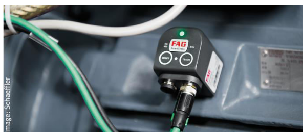
Figura 28 - FAG SmartCheck Instalada em um motor elétrico.
