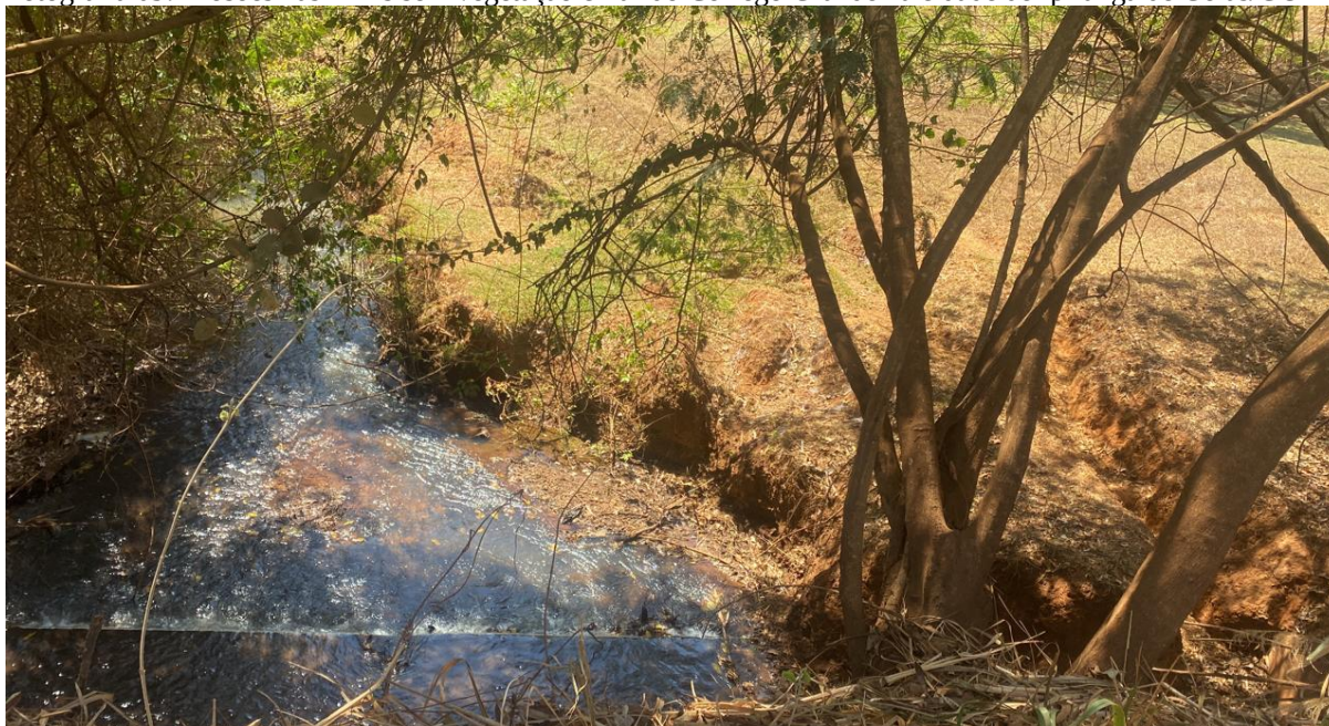
Fotografia 09: Erosões nas APPs sem vegetação ciliar do Córrego Grande na cidade de Ipiranga de Goiás/GO
