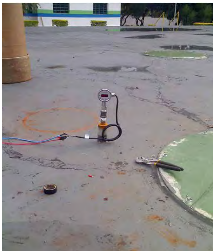
Figura 12D: Medidor de pressão instalado no biodigestor da Estação de tratamento da Águas Guariroba.
