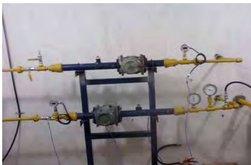
Figura 5.70: Linha de Filtragem do Biogás com os medidores instalados.
