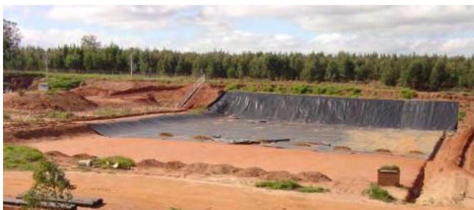
Figura 10: Camada de polietileno do aterro sanitário. Fonte: Wikipedia/aterro sanitário.
