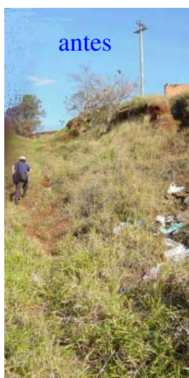
Figura 5: Erosão no município de Botucatu. Fonte: Ramon Bicudo.
