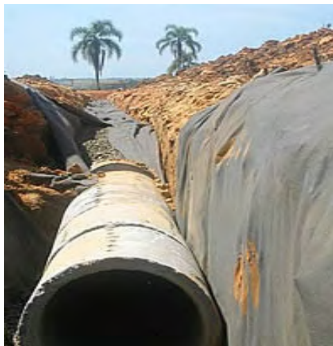
Figura 9: Dreno de chorume do aterro sanitário. Fonte: Wikipedia/aterro sanitário.
