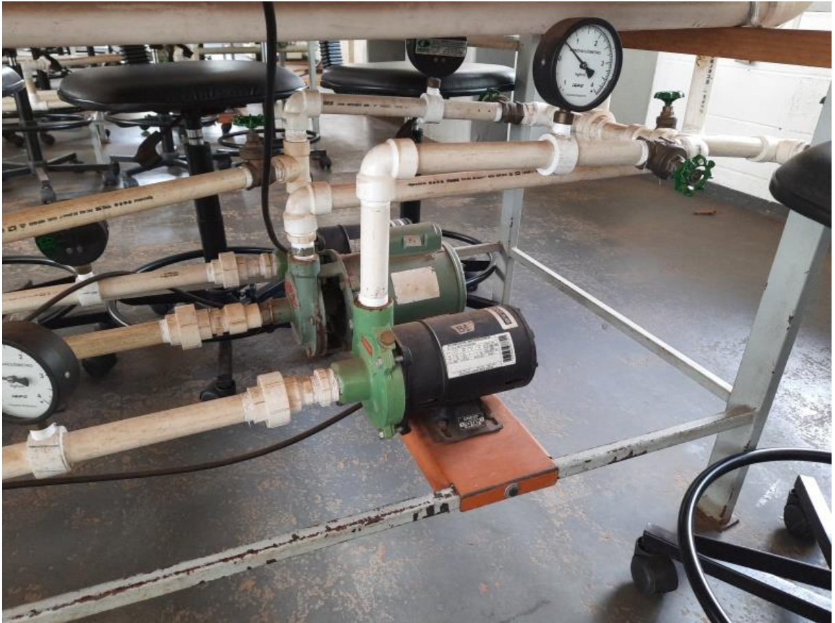
Figura 41 - Bombas hidráulicas utilizadas no controle do fluxo d'água
