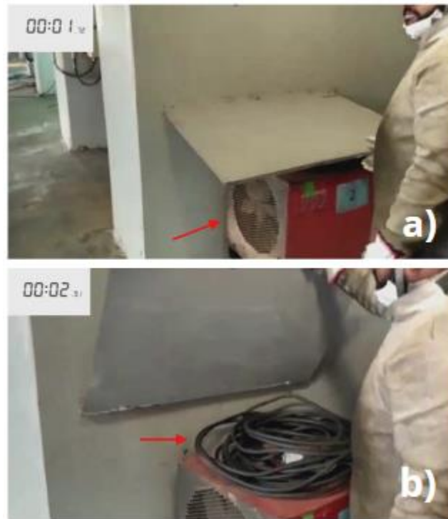
Figura 15 – (a) máquina de solda protegida pelo telhado (b) cabos armazenados sobre a máquina
