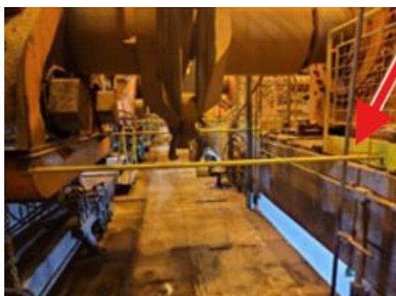
Figura 26 – Restrição de acesso aos ACIPs
