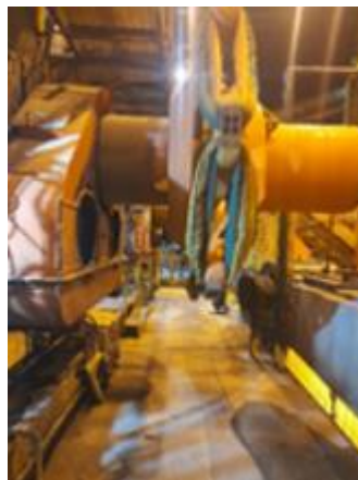
Figura 21 – Ausência de restrição de passagem entre ACIPs da moenda
