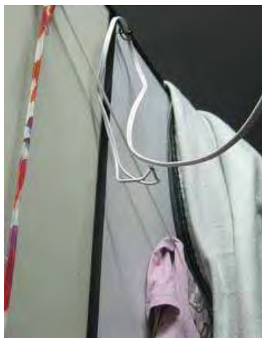
Imagem 13 – fiação elétrica na oficina (RB)
