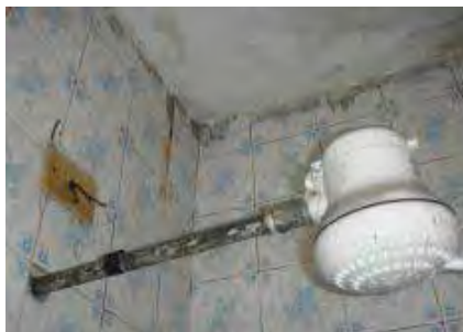
Imagem 8 – chuveiro para os trabalhadores (RB)
